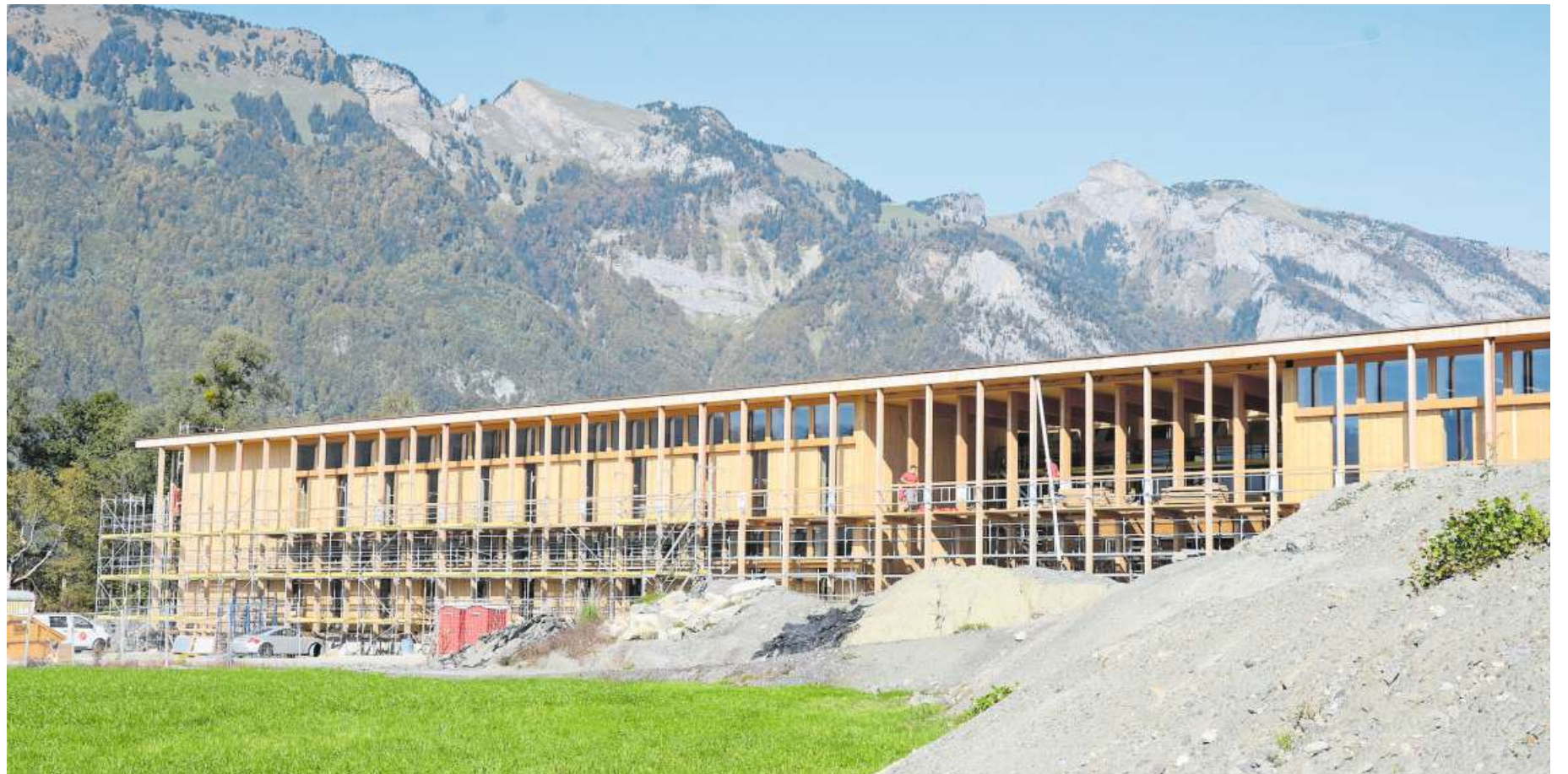
Die letzten Arbeiten sind im Endspurt: Am Montag können die Nutzer den Neubau der Landwirtschaftsschule beziehen.
